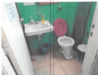
BANHEIRO - NECESSITA REPAROS PORTA E REVESTIMENTOS
