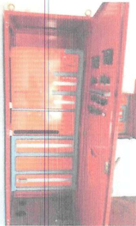
Panel da casa de bombas desmontado
